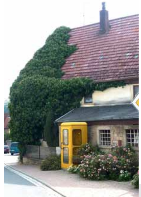
Bild 21: Bei „vergessenem“ Efeu sind Schäden im Dach vorprogrammiert.
